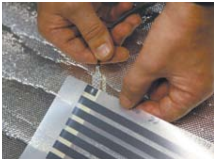
Рис. 5 Установка контактных зажимов
